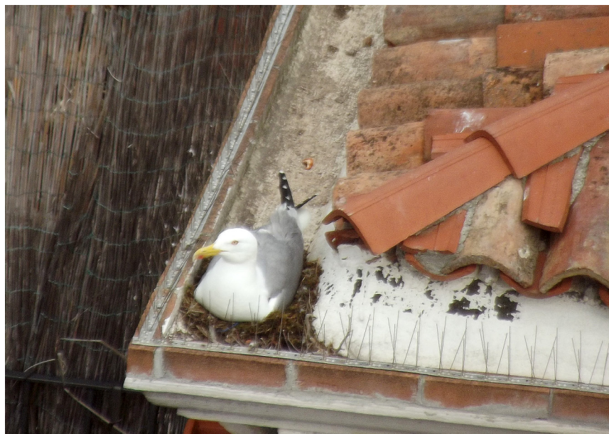
Figura 13. Venezia. Nido di gabbiano reale sul cornicione di una abitazione. In questo caso i dissuasori, installati sull'edificio in modo non opportuno, non hanno impedito all'animale di colonizzare il sito.
